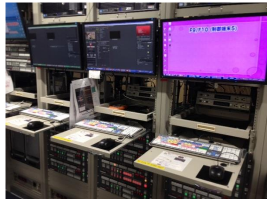
図 4. MOG Control Panel 操作端末
