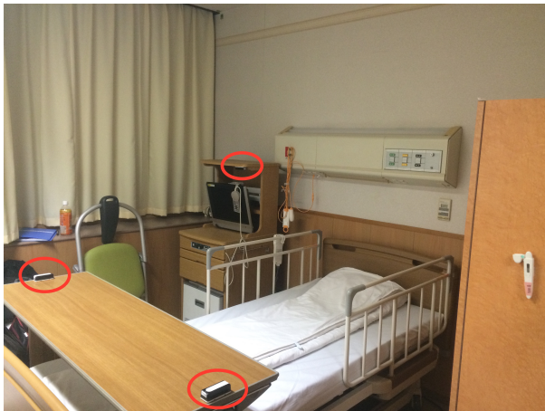
図 1 赤外線ビーコンの設置例 (病室)
